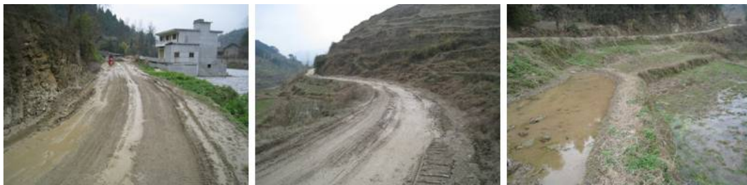
图2 到校乡村公路部分路段路况组图
