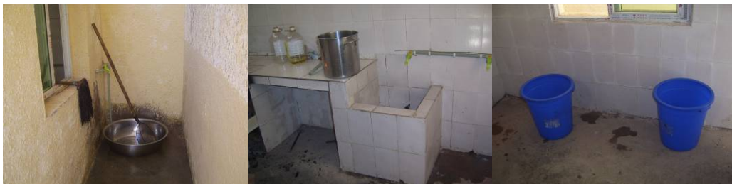
图 12 墙面地面卫生组图
