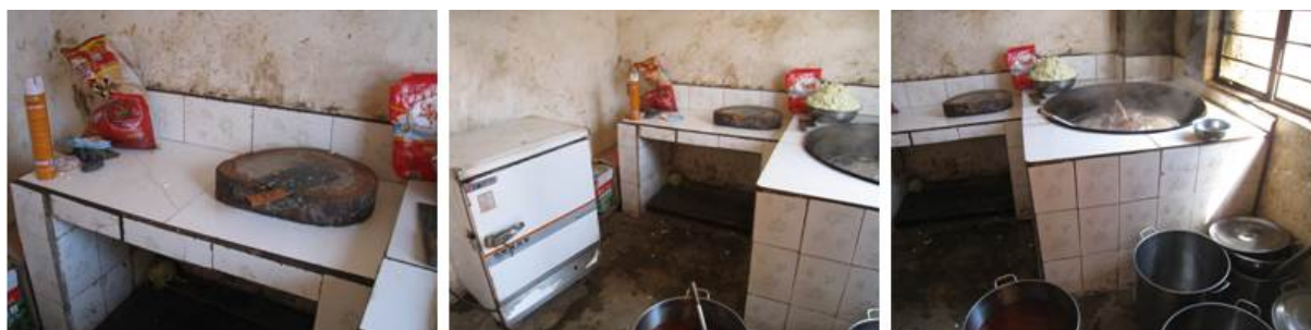
图6 厨房墙面地面情况组图
